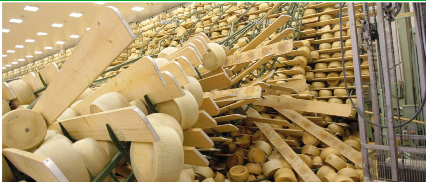
Maggio 2012. Il terremoto che ha colpito l'Emilia-Romagna ha danneggiato anche i magazzini per la stagionatura del Parmigiano Reggiano (nella foto, un deposito crollato a San Possidonio, provincia di Modena)
